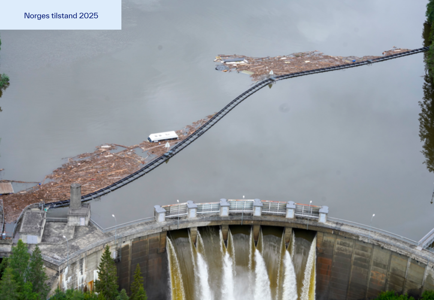
Skader etter ekstremværet Hans. Foto: Ole Berg-Rusten / NTB
