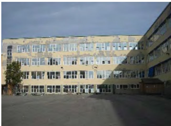
Sinsen skole FØR: Bygget hadde stor energilekkasje og høye strømutfgifter. Foto: Svein Bjørberg
