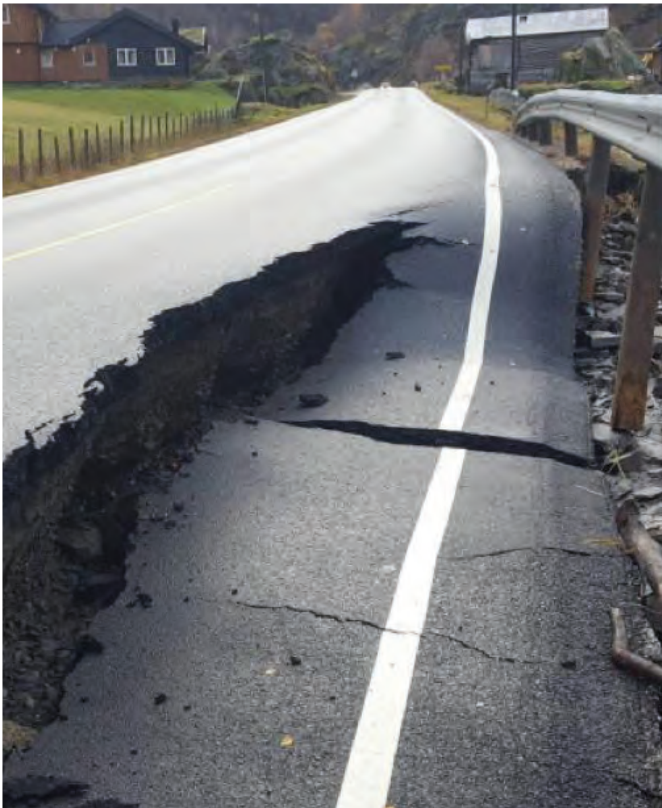
Figur 17 Flomskader fv 55, Lom. Foto: Statens vegvesen (Fra Handlingsprogrammet for fylkesveger 2022-2025 Innlandet)
