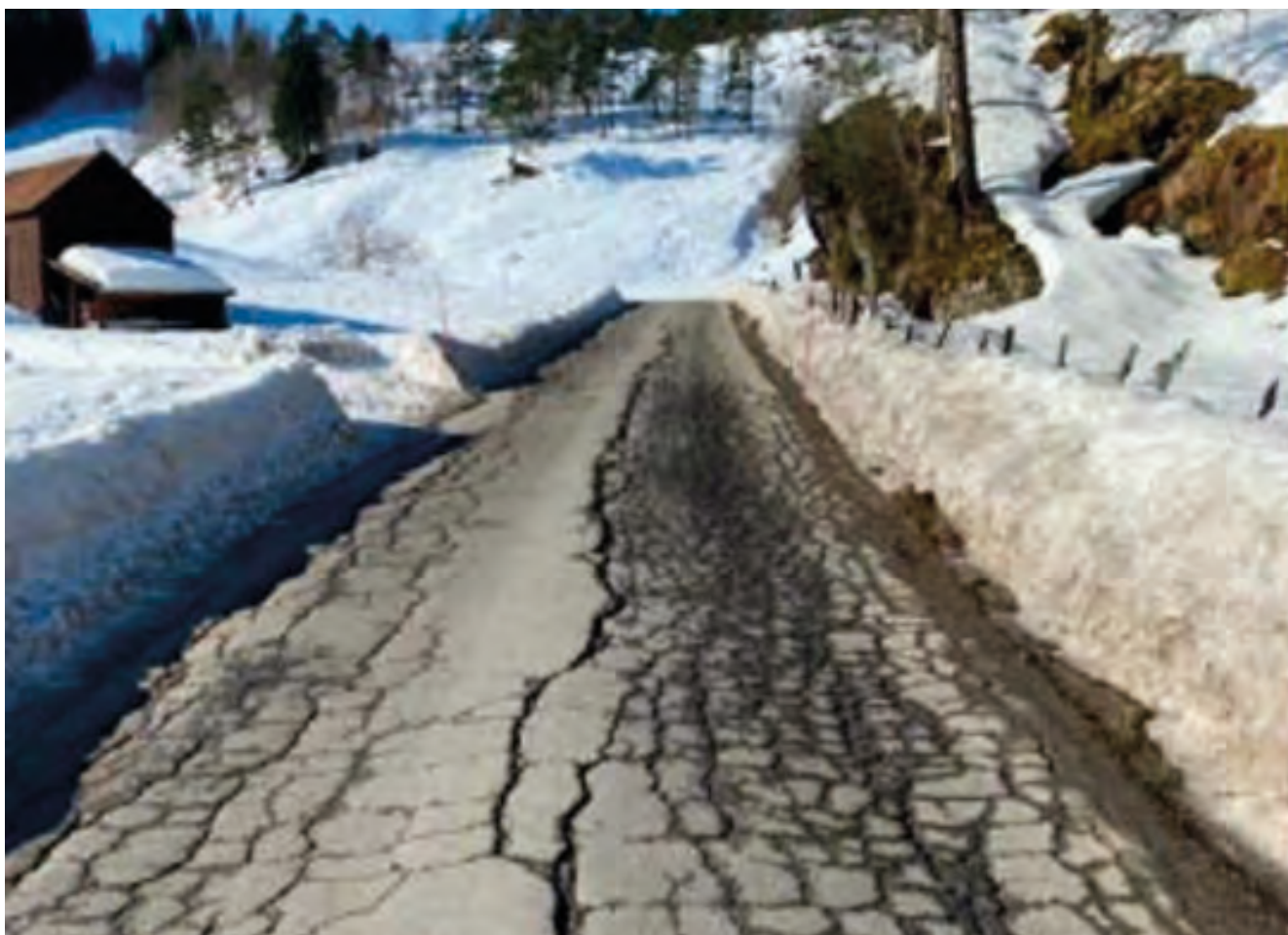
Figur 14 Fv5122 Porsmyrvegen (Fra Drifts og vedlikeholdsstrategi Vestland). Dekket ødelegges av dårlig bæreevne på vegen.
